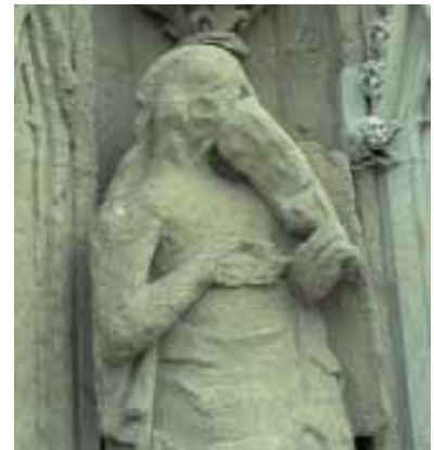
Monument afectat per la pluja àcida.
